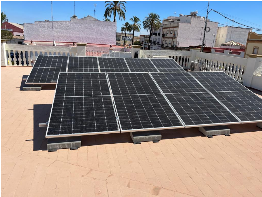
Paneles Fotovoltaicos mejora Centro Guadalinfo
