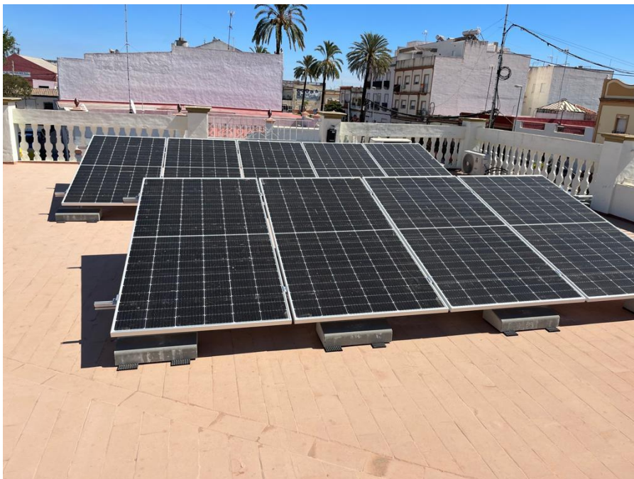
Paneles Fotovoltaicos mejora Centro Guadalinfo
